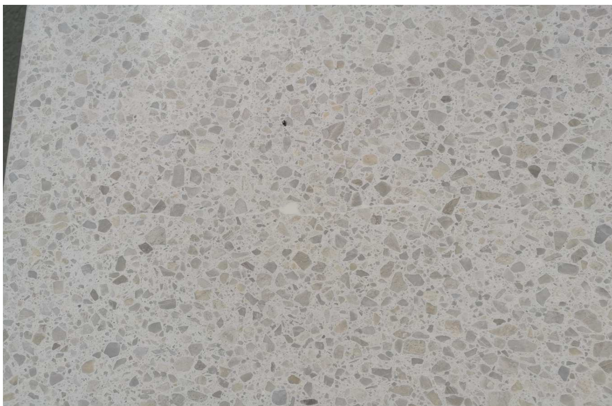
Foto opravené praskliny – bílé teraso – na druhý den, foto zblízka – cca 20cm
