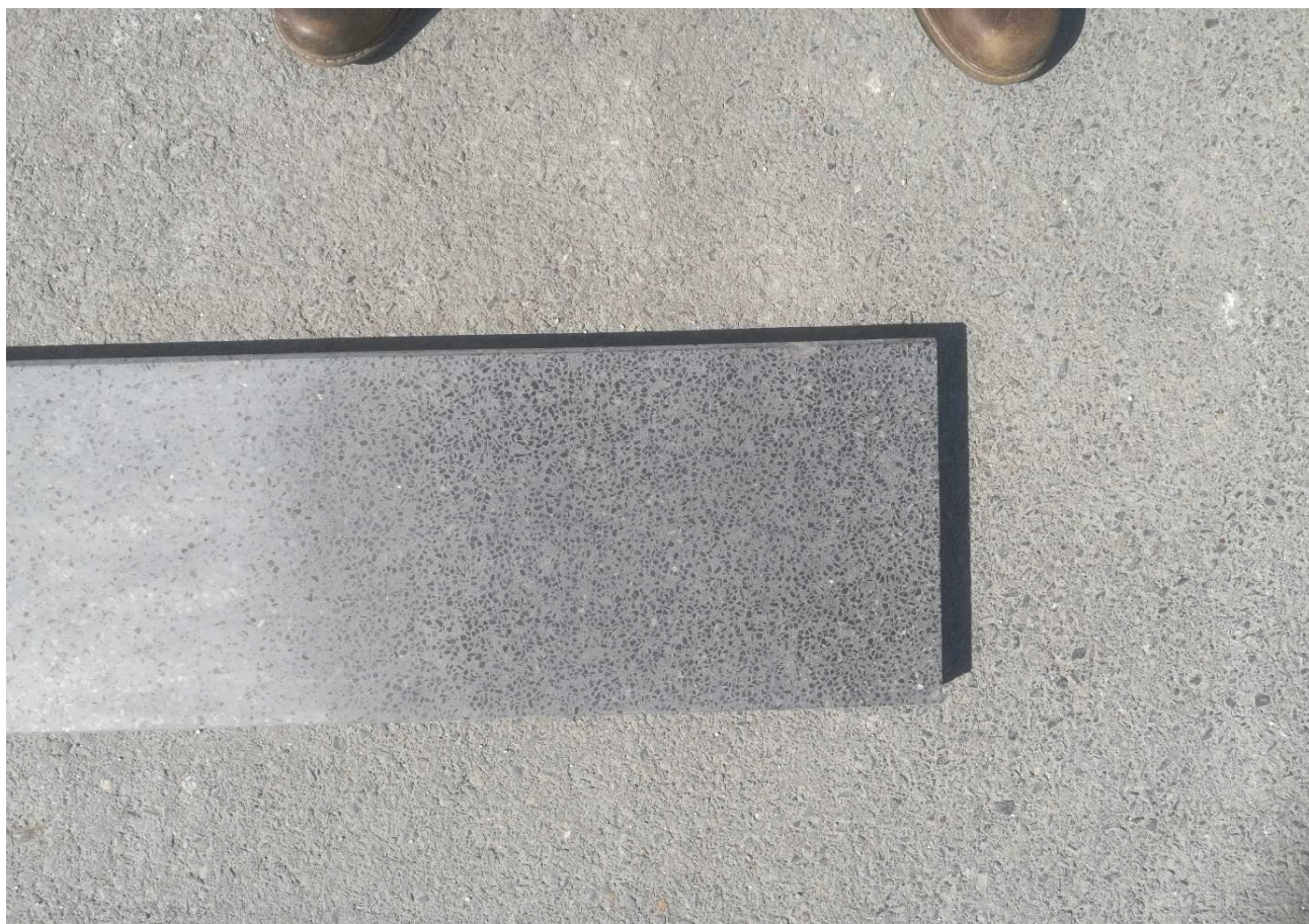
Foto opravené praskliny – černé teraso – na druhý den, foto z výšky cca 1,0 – 1,2m
